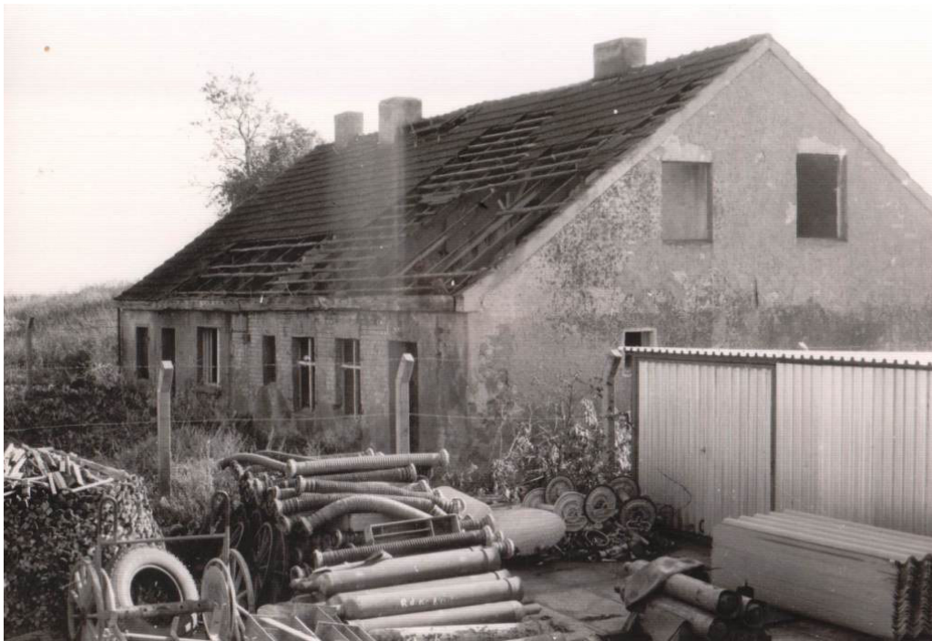
Foto: 63 Haus 3 (vormals als Lager genutzt), wurde 1988 in Eigenleistung abgerissen, da der bauliche Zustand eine Sanierung nicht mehr lohnte.
